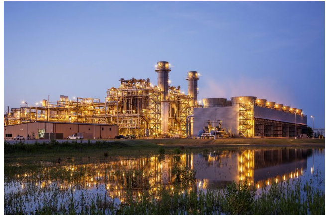
2: HRSG at Woodbridge Energy Center, USA
